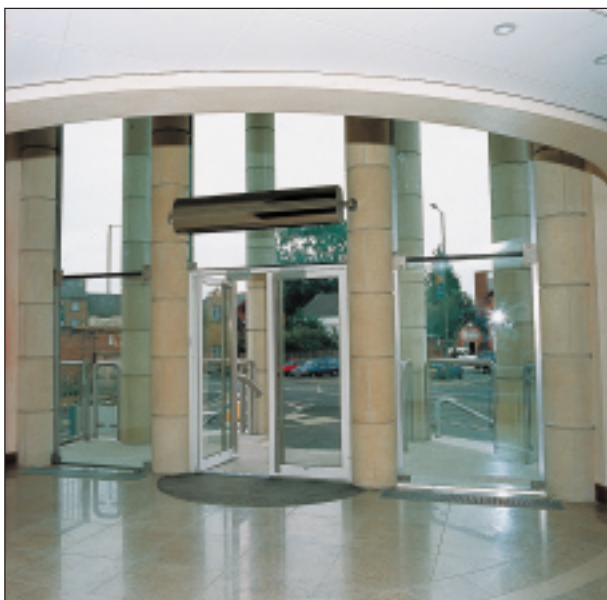
Воздушные завесы Коринта обеспечивают комфорт и прекрасно сочетаются с любыми, самыми эксклюзивными интерьерами. Один из входов магазина Smapter House (Великобритания), где выбрана горизонтальная установка завес с корпусами из полированной нержавеющей стали.
